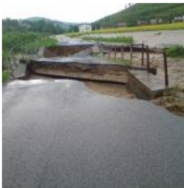
Pohľad na zničený most pred obcou
